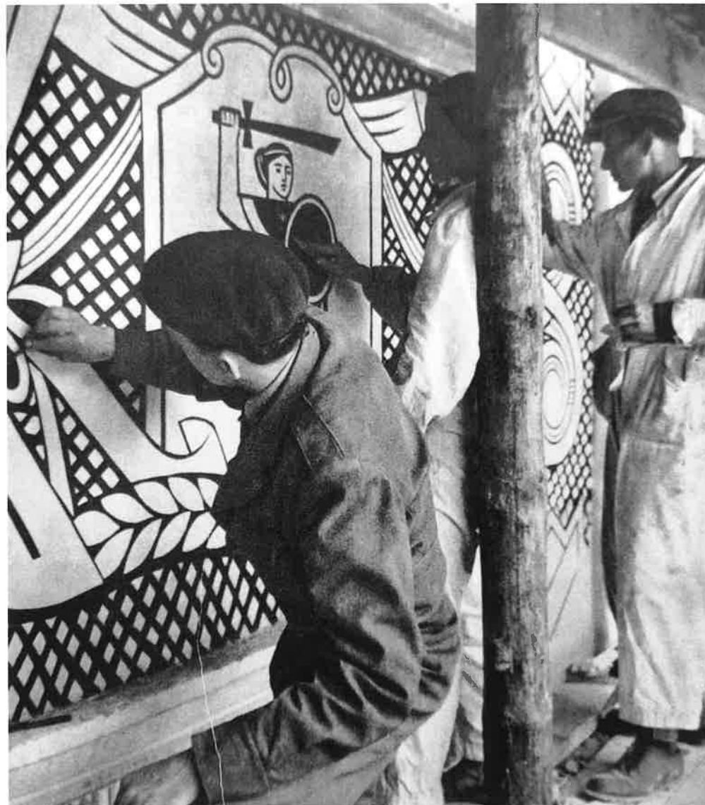
Il. 23 Prace przy sgraffito na elewacji, fot. 1952, E. Hartwig, repr. MDM, Janowski, 1955
