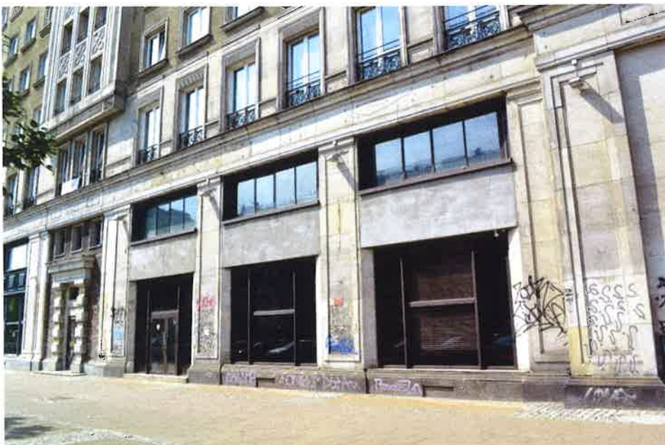
II. 43 Elewacja frontowa, witryna lokalu użytkowego (d. bar rybny; „Flis”), nieużytkowany
