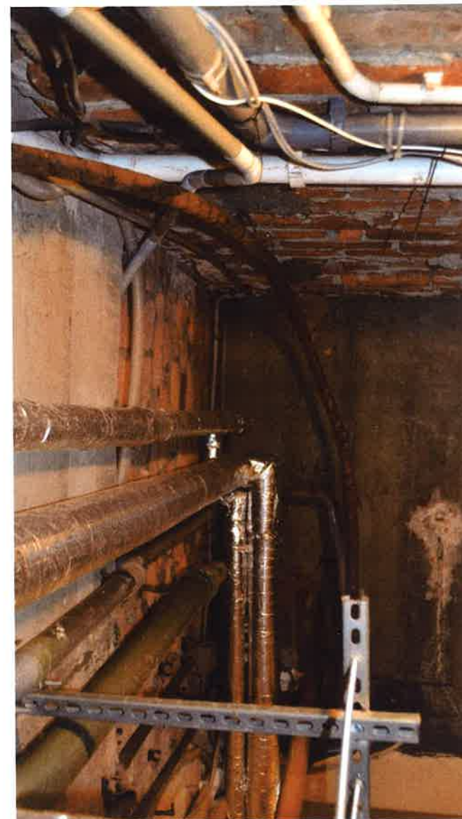
II. 103 Instalacje prowadzone podsufitowo w korytarzu piwnicznym
