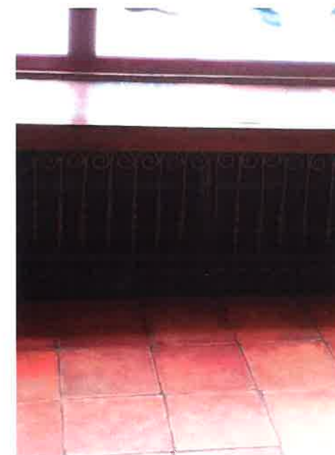
Il. 123 Lokal d. baru Szanghaj, ob., siedziba biblioteki, przed remontem, parter, kratka zabezpieczająca pod witrąną okienną, fot. MWKZ, 2018
