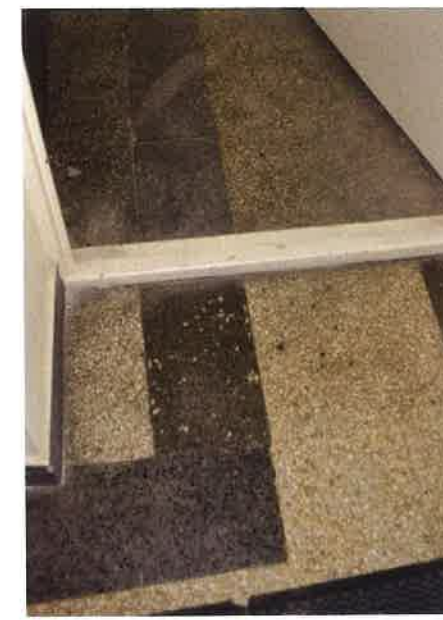
II. 97 Posadzka między parterem a piwnicą
