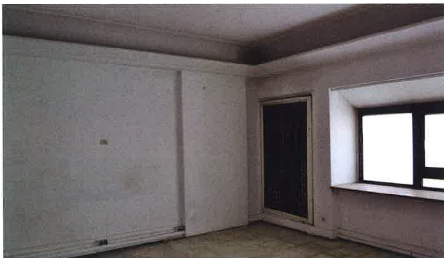
Il. 81 Wnętrze d. baru mlecznego „Złota Kurka”, antresola, (dokumentacja w karcie Lokal użytkowy, d. bar mleczny, „Złota Kurka”, budynek 1B MDM, ul. Marszałkowska 55/73 )
